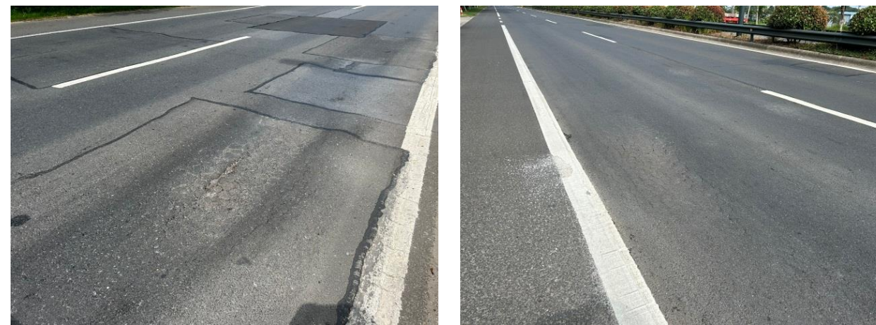
大成浜小桥~江宜高速下穿段 K3+300~K3+350 (上行 1、2 车道)、K2+650~K3+930 (下行 1、2 车道)
