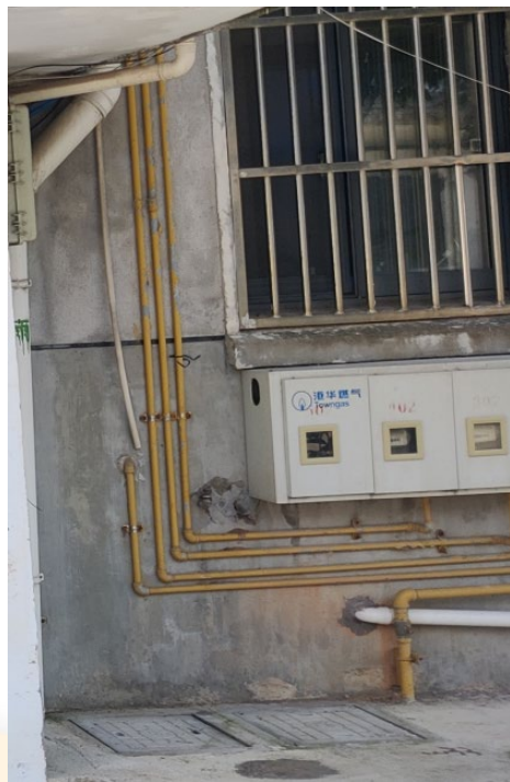
燃气设施现状
