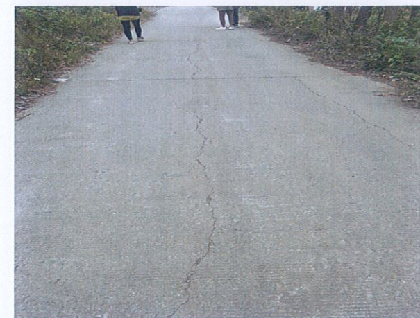
K0+410~K0+495 处连续纵向裂缝
