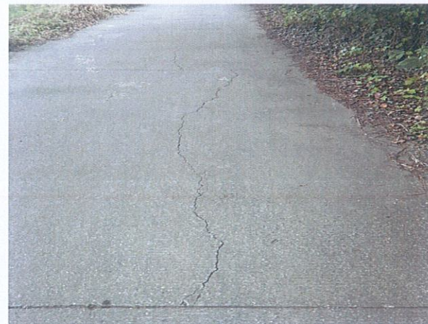
K0+130~K0+150 处连续纵向裂缝
