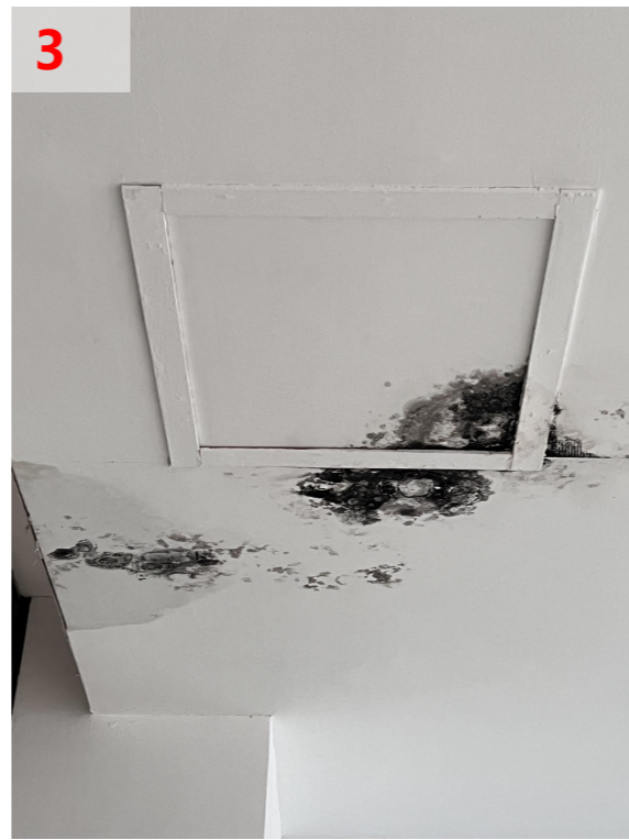
3 二层西侧连廊顶面渗水
