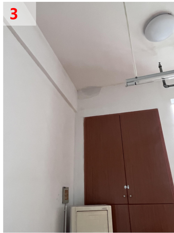
三层大四班教室顶面多处渗水
