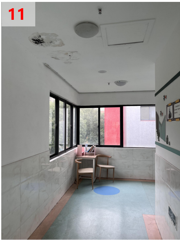
二层走廊顶面渗水
