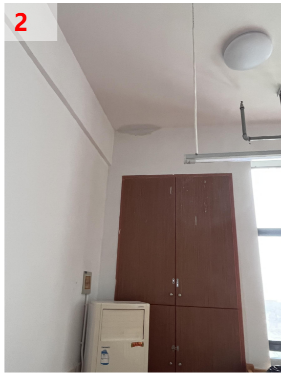
三层大五班教室顶面渗水
