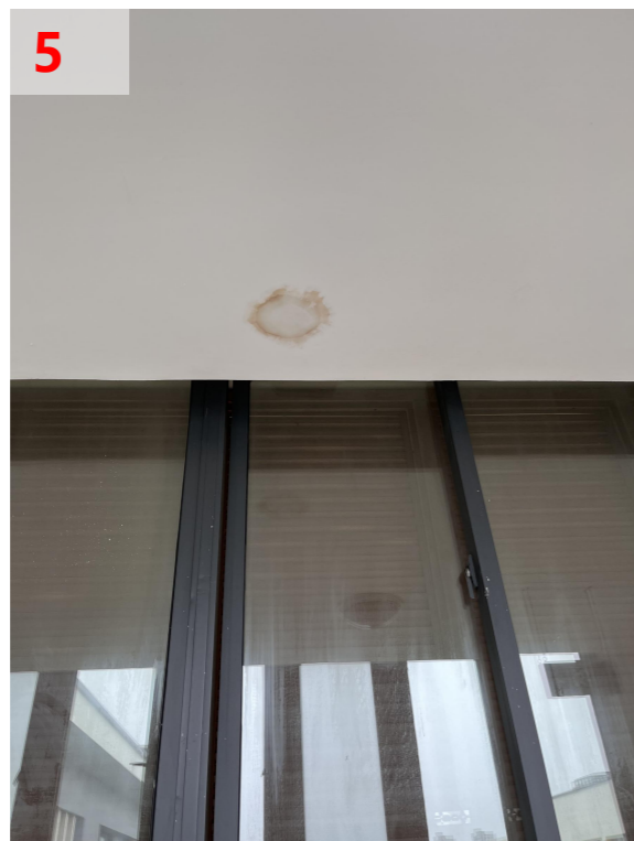
三层连廊顶面渗漏
