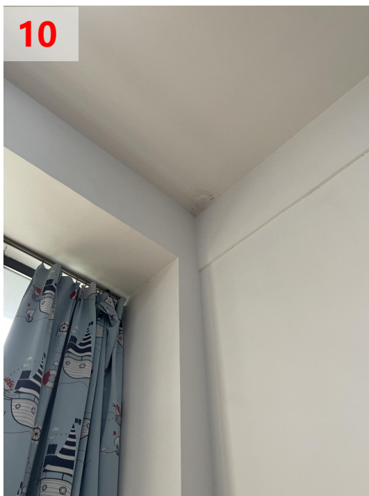
二层教室顶面多处渗水
