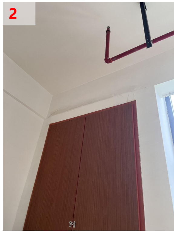
2 二层大二班教室顶面渗水
