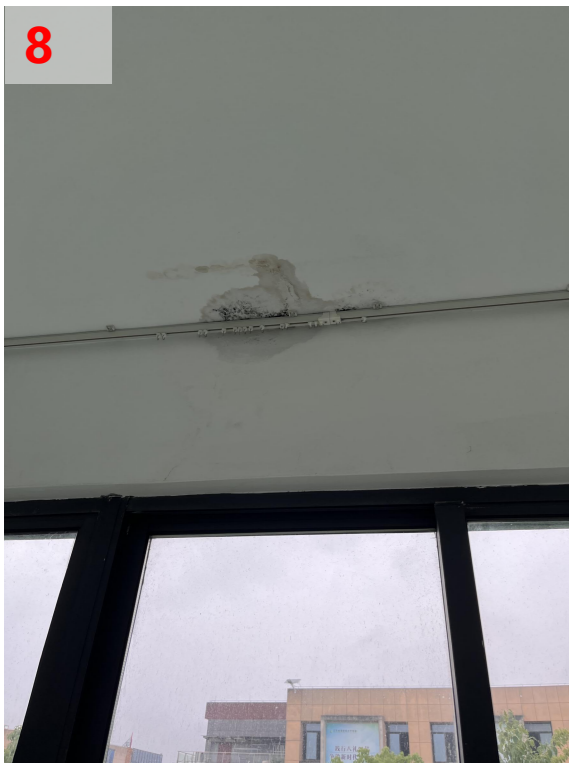
二层大一教室顶面渗水
