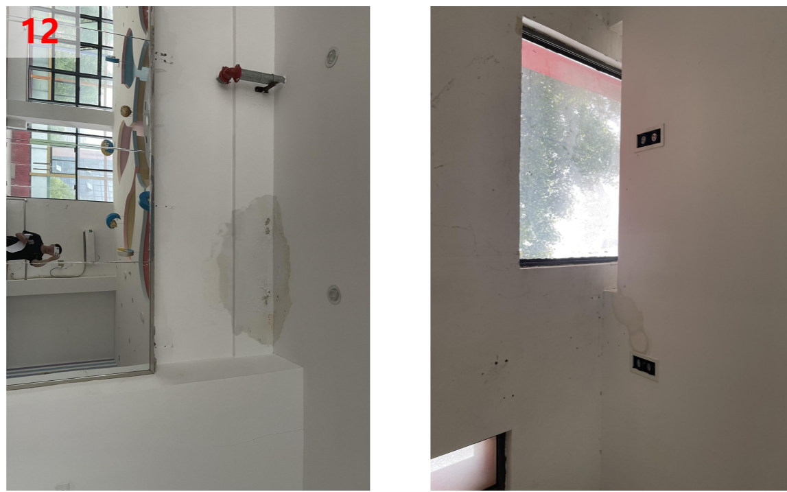
二层多功能教室顶面多处渗水
