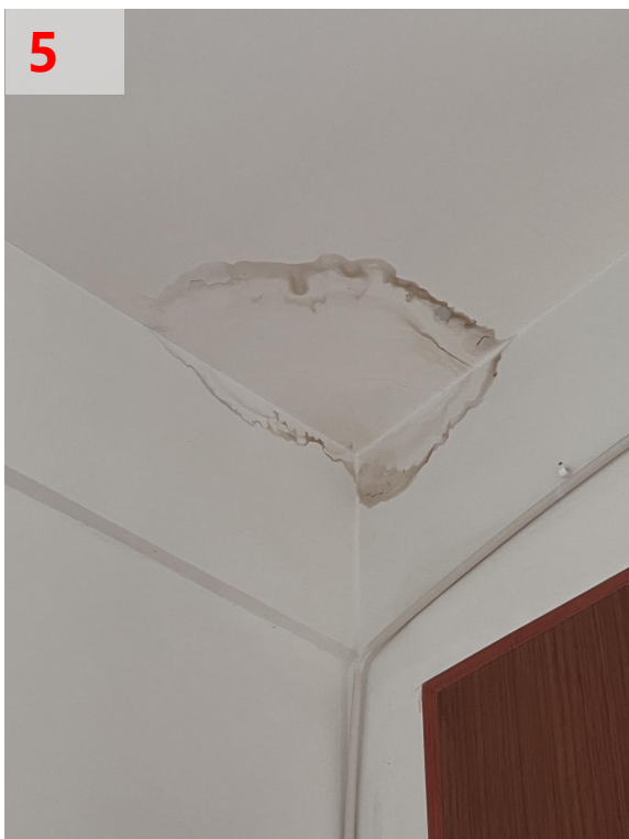
5 二层中一班顶面渗水
