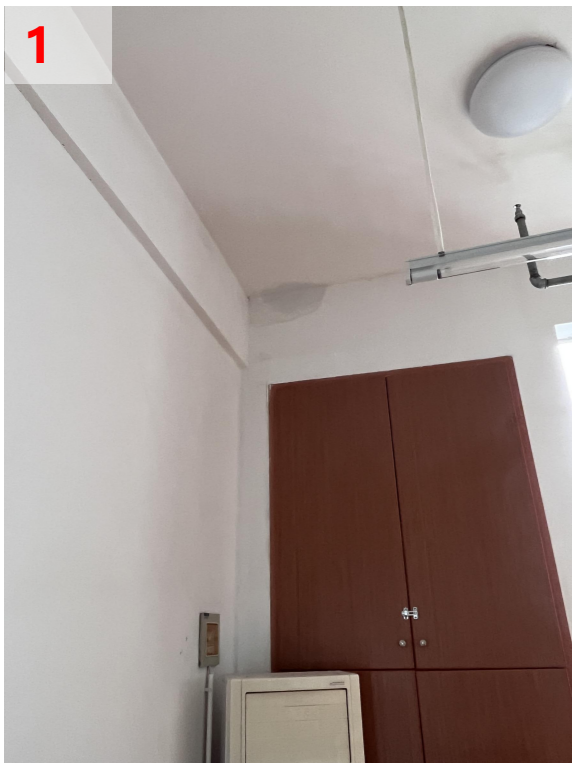
三层教室顶面渗水
