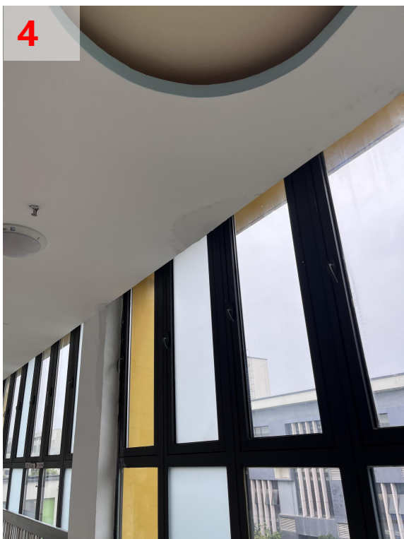
三层走廊顶面渗水
