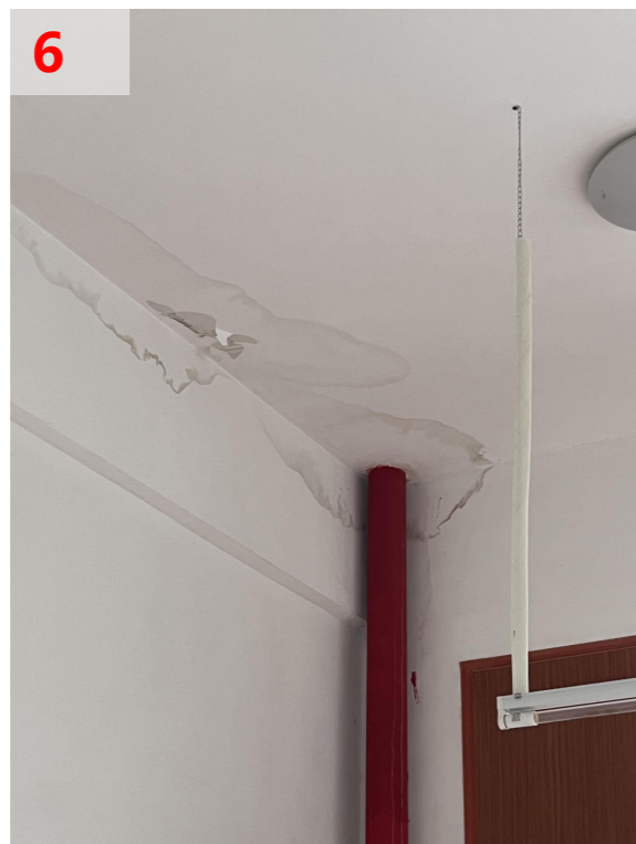
6 二层中二班顶面多处渗漏
