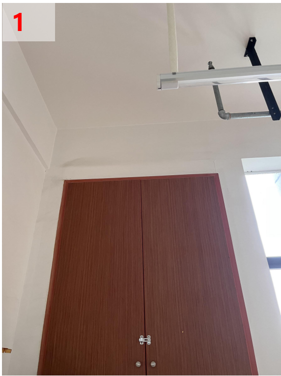
1 二层大一教室顶面渗水
