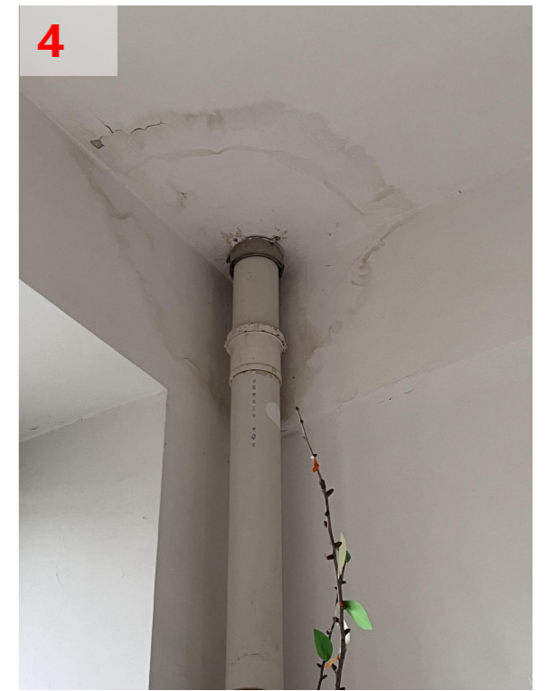
4 二层连廊东侧楼梯间顶面渗水
