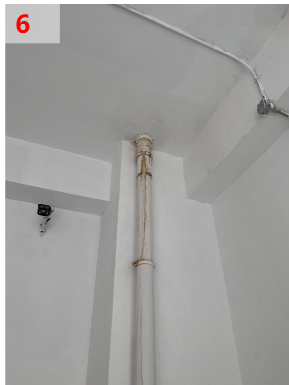
三层楼梯间管道渗漏
