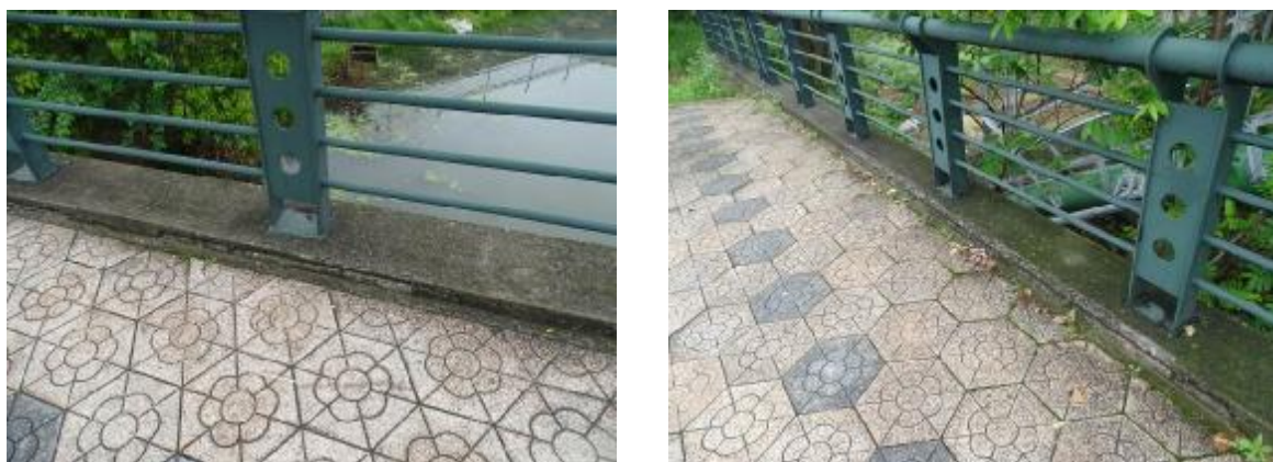
图 5.35 栏杆基座抹面、外侧砣露筋
