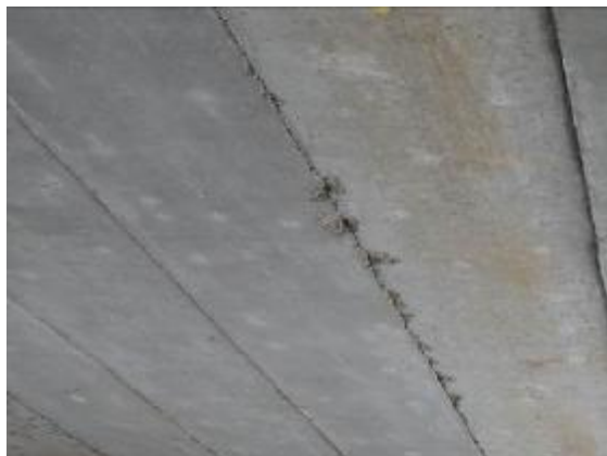
图 5.21 板梁底砼剥落
