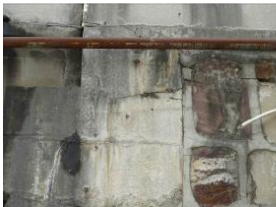
图 5.3 桥台混凝土台帽局部开裂
