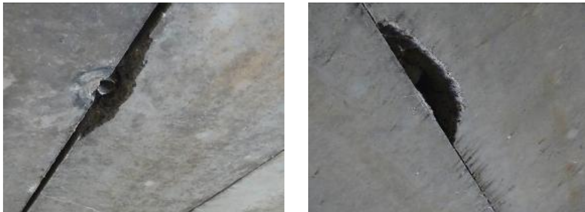
图 5.28 泄水孔处板底 砼剥落
