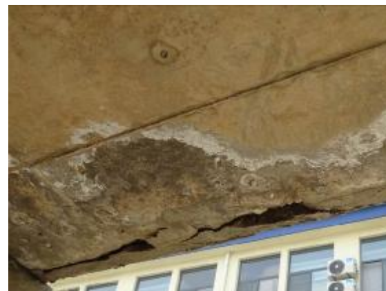
图 5.12 梁底通剥落露筋
