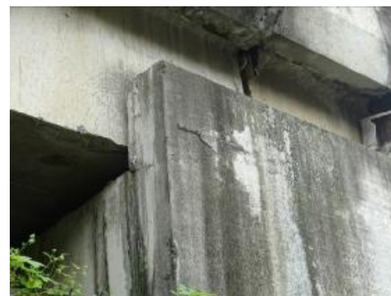
图 5.7 盖梁挡块局部开裂
