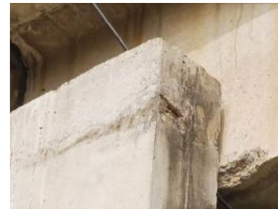
图 5.6 挡块砼剥落露筋
