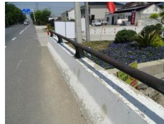
图 5.24 护栏钢管破损
