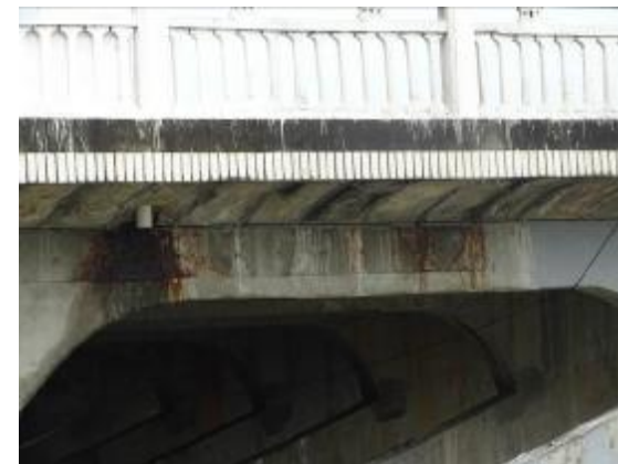
图 5.26 上部结构钢构件锈蚀
