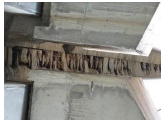
图 5.22 挑臂损坏严重
