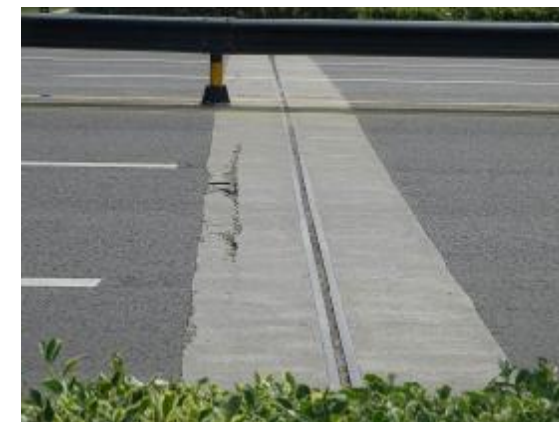
图 5.16 伸缩缝缝口砼破损
