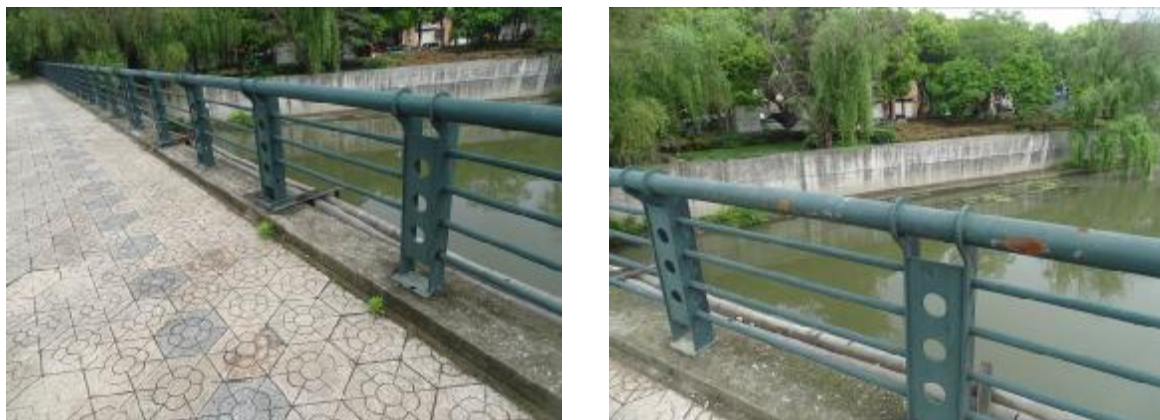
图 5.34 栏杆钢管缺失、锈蚀、掉漆
