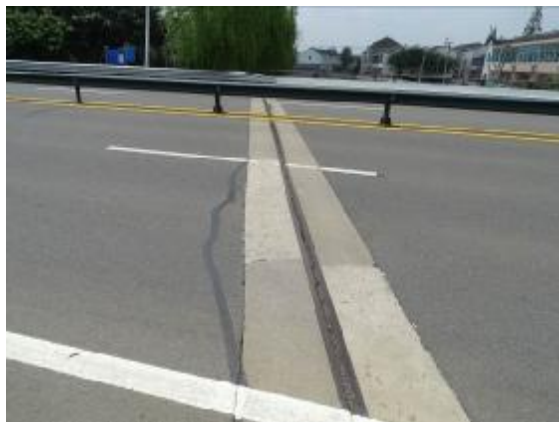
图 5.19 伸缩缝橡胶条破损
