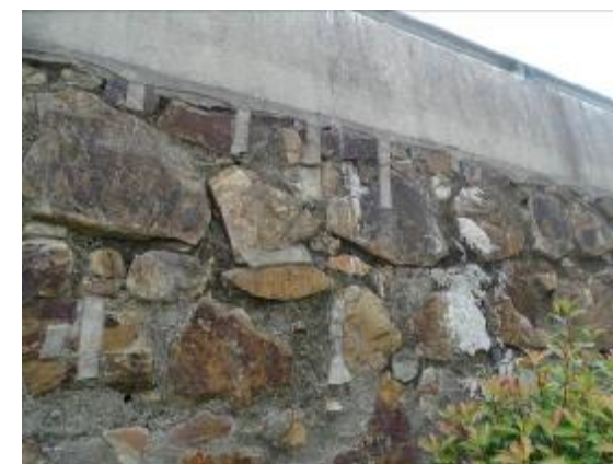
图 5.8 挡墙勾缝脱落
