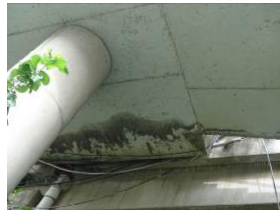
图 5.5 板梁砼剥落露筋
