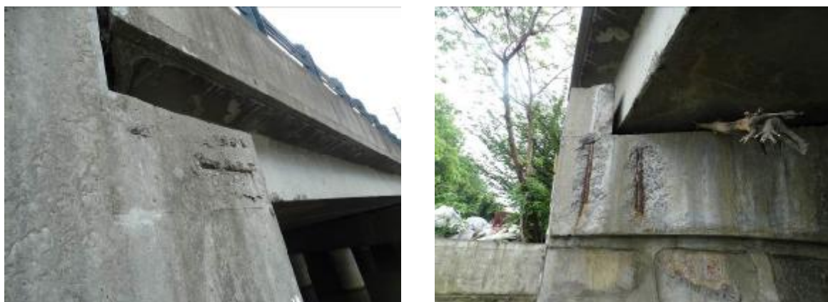
图 5.36 栏杆基座抹面、外侧砣露筋
