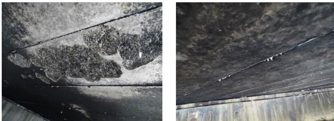
图 5.29 板底火烧严重
