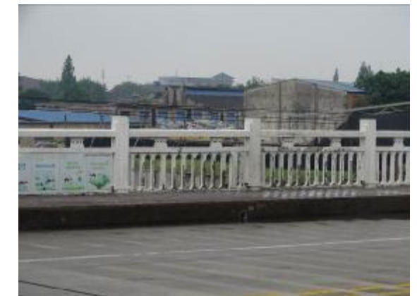
图 5.27 栏杆涂料脱落
