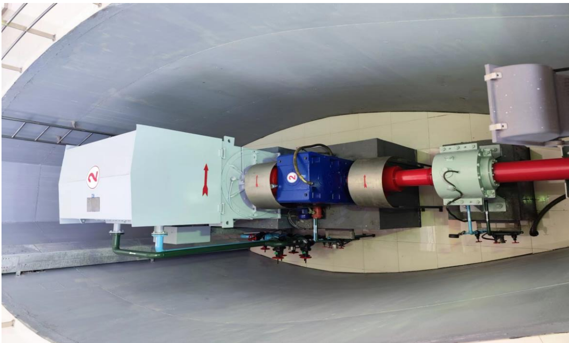
图 1.3-10 遥观北枢纽 2#水泵机组及电机现状
