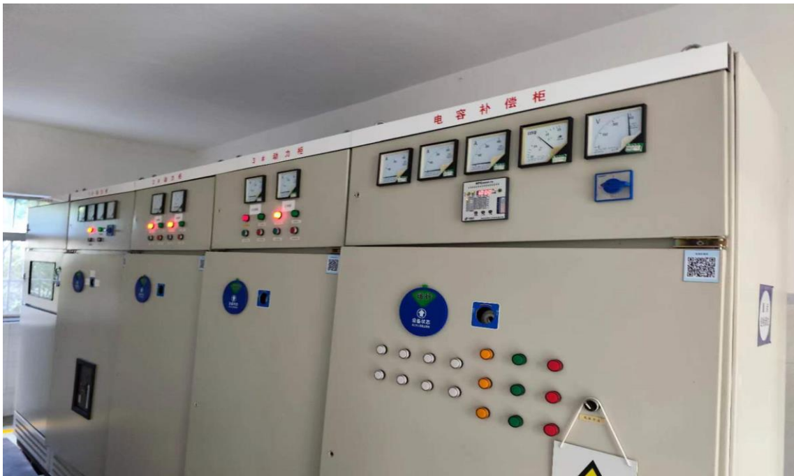
图 1.3-7 雅浦港枢纽机电柜柜门错位变形
