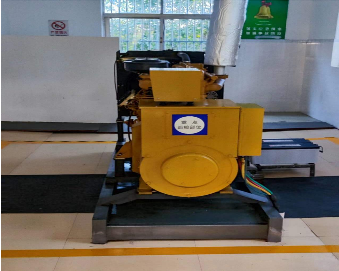
图 1.3-19 雅浦港枢纽柴油发电机间地基沉降变形现状
