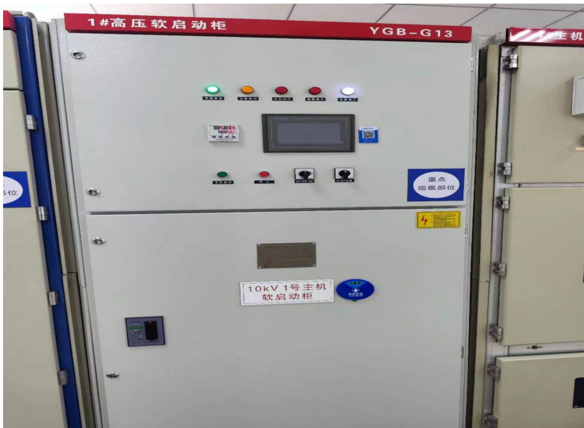
图 1.3-5 遥观北枢纽高压软启动柜无法正常使用
