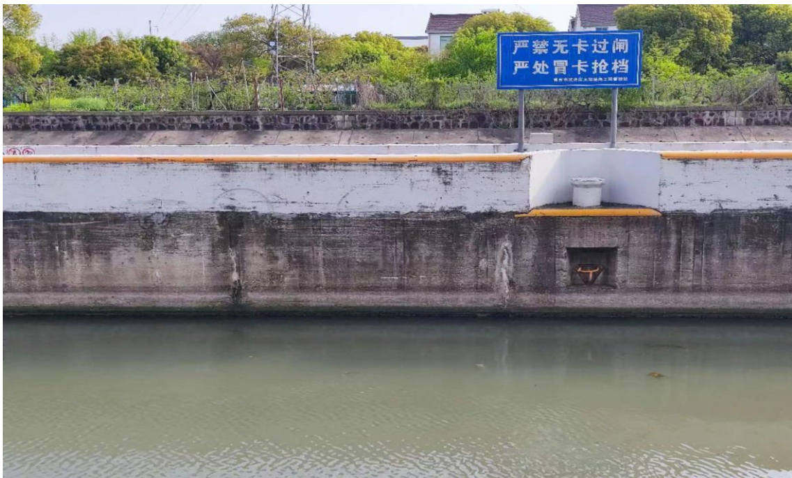
图 1.3-11 武进港枢纽船闸闸室翼墙现状
