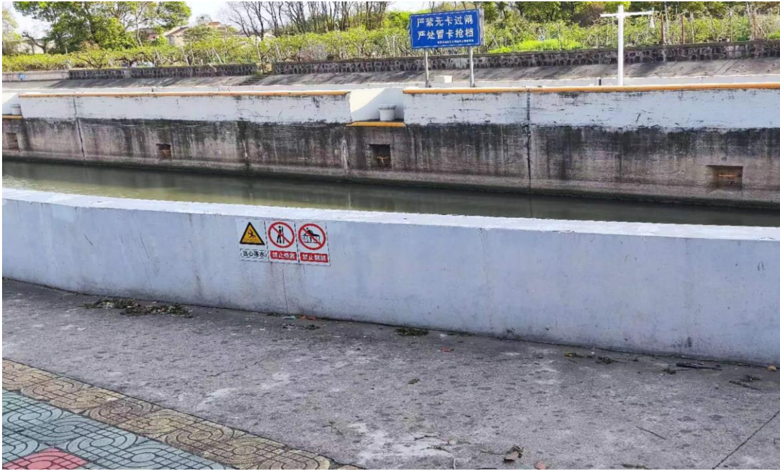
图 1.3-3 武进港枢纽挡浪墙缺少防护栏杆
