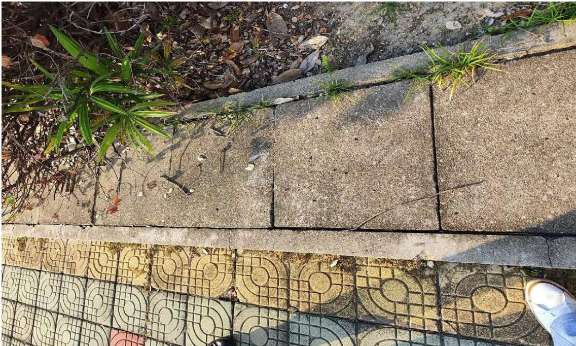
图 1.3-4 武进港枢纽电缆井混凝土盖板变形、破损
