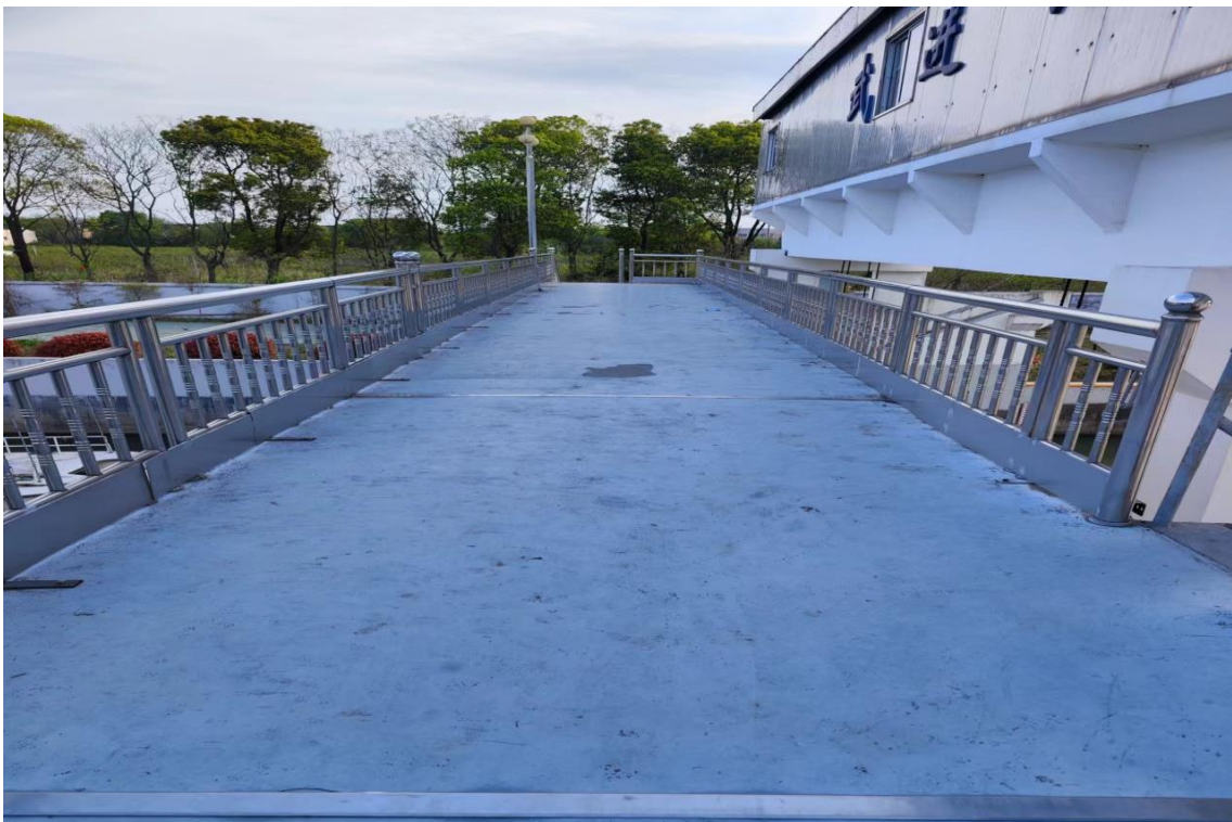
图 1.3-14 武进港枢纽上闸首工作桥桥面涂料破损现状
