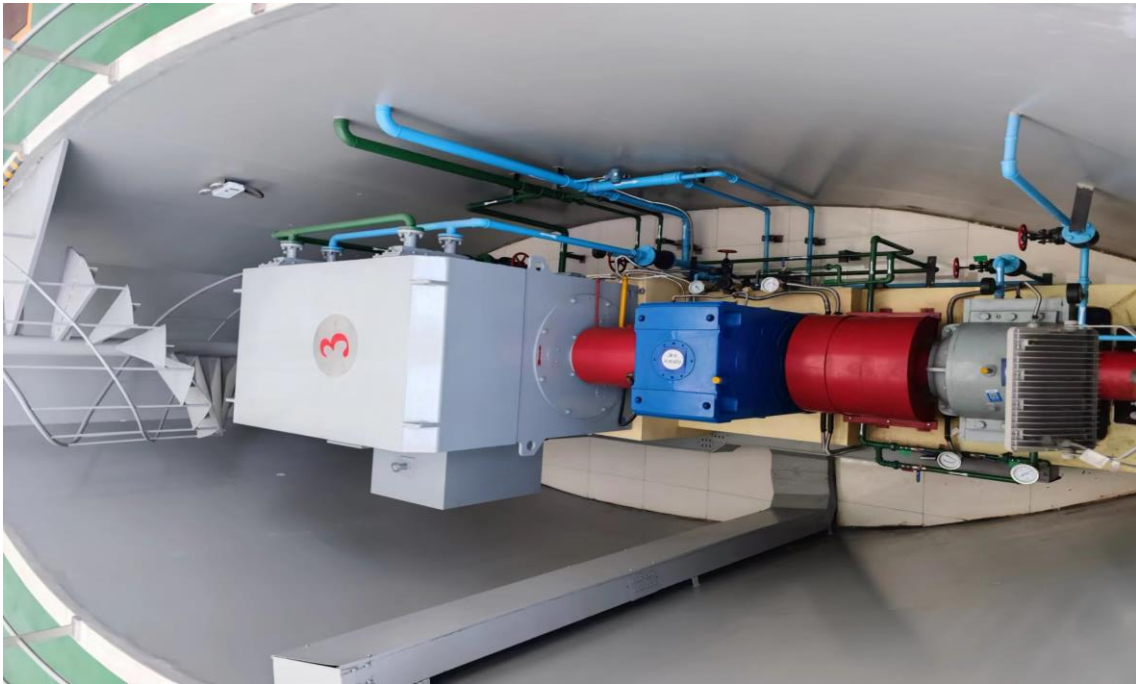
图 1.3-9 遥观南枢纽 3#水泵机组及电机现状
