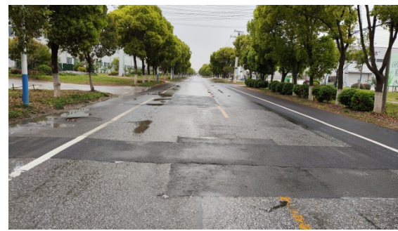
修补密集、路面起伏、平整度差
